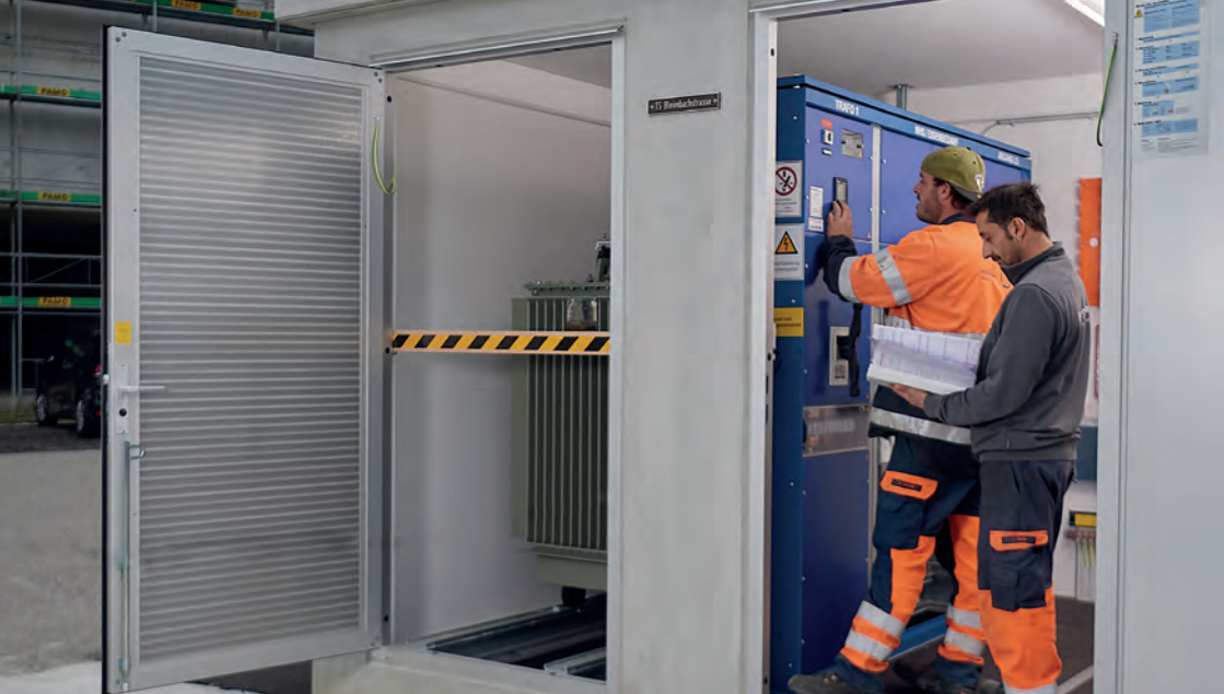
Thomas Zürcher und Leandro Florio in der neuen Transformatorenstation vor dem Hotel Bösiger in der Bleienbachstrasse.
